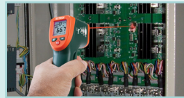
检测断路器面板上的热点
