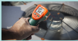
测试 HVAC (暖通空调) 系统内的温度
